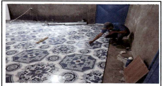
Foto 4. En esta fotografía se observa la sustitución de 35 metros cuadrados de piso de torta de cemento por piso cerámico en un aula del establecimiento educativo.
